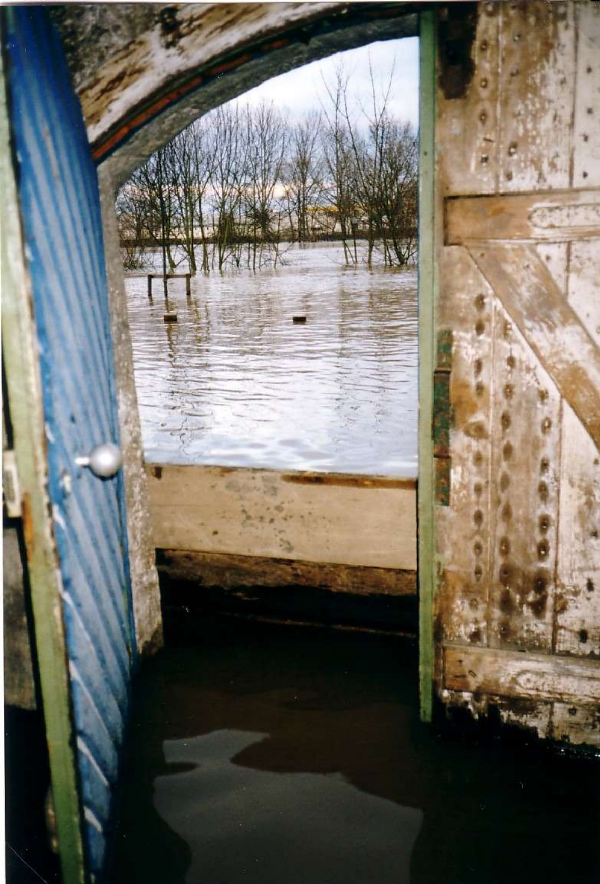
Blick aus unserem Keller , die Barriere (und die Pumpen) halten den Wasserspiegel drinnen ca. 30 cm niedriger als draußen.
