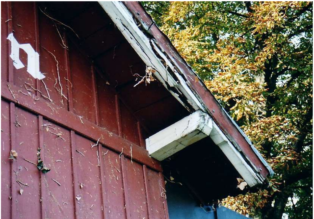
Im Bild deutlich erkennbar der total angefaulte Sparren und die durch den Efeubewuchs stark im Mitleidenschaft gezogene Bootshausaußenwand
